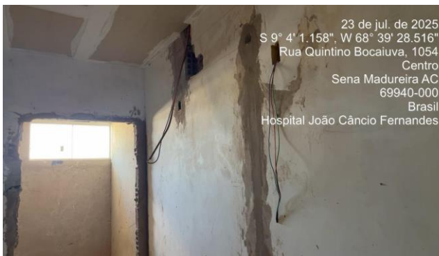
Imagem 54 TUBULAÇÃO DE COBRE
