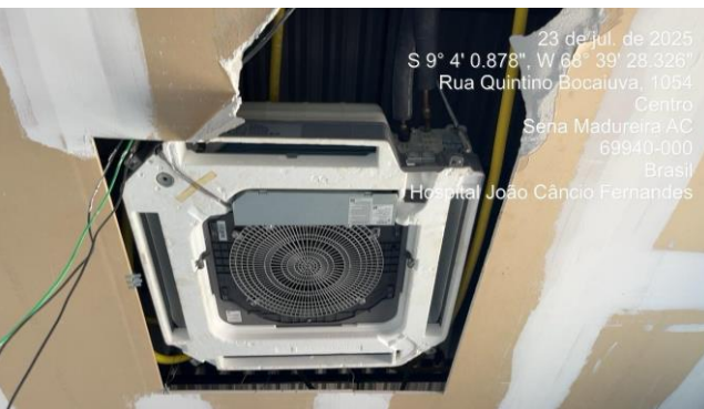
Imagem 53 TUBULAÇÃO DE COBRE
