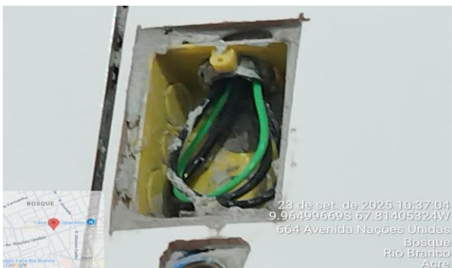
Imagem 31 INSTALAÇÕES ELÉTRICAS EXECUTADAS
