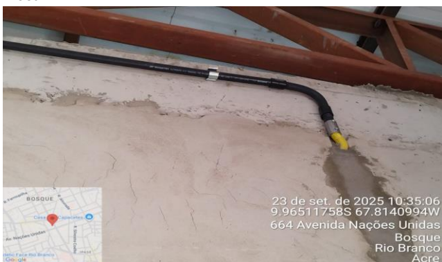
Imagem 33 INSTALAÇÕES ELÉTRICAS EXECUTADAS
