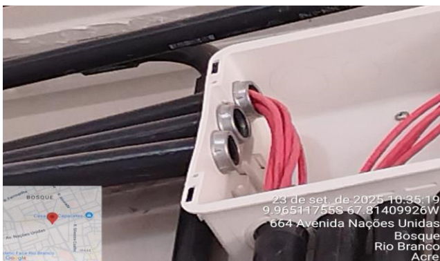
Imagem 32 INSTALAÇÕES ELÉTRICAS EXECUTADAS
