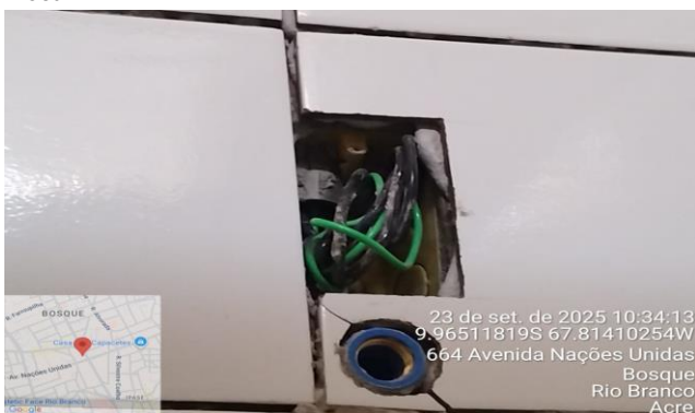
Imagem 34 INSTALAÇÕES ELÉTRICAS EXECUTADAS
