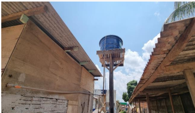
Imagem 5 Reservatório elevado para o canteiro de obra
