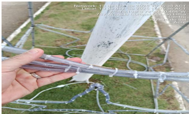
Imagem 6 MANGUEIRA LUMINOSA LED 13MM 127V FORNECIMENTO E INSTALAÇÃO
