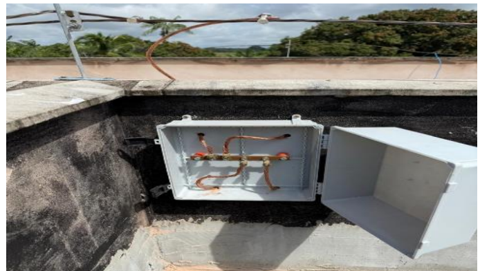
Imagem 28 QUADRO DE BARRAMENTO DE EQUIPOTENCIALIZAÇÃO.
