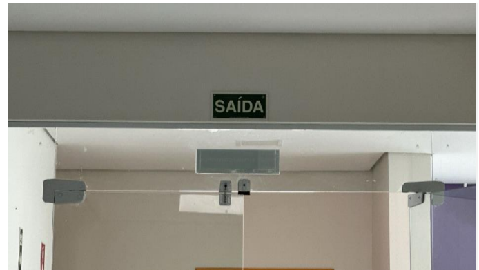
Imagem 24 PLACA DE SINALIZACAO DE SEGURANCA CONTRA INCENDIO
