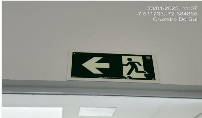
Imagem 25 PLACA DE SINALIZACAO DE SEGURANCA CONTRA INCENDIO
