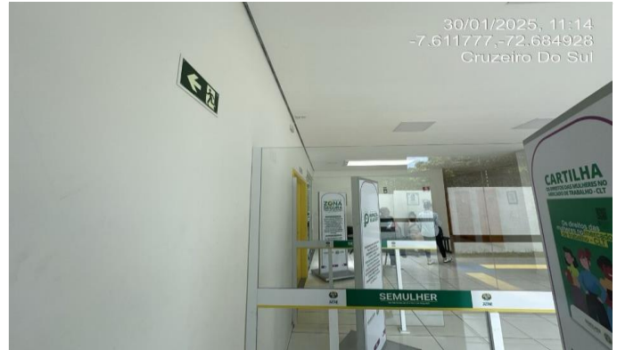
Imagem 26 PLACA DE SINALIZACAO DE SEGURANCA CONTRA INCENDIO
