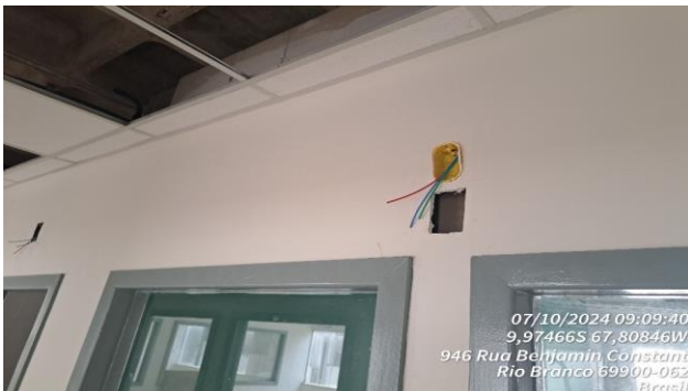
Imagem 77 INSTALAÇÕES ELÉTRICAS DO PRÉDIO ANEXO
