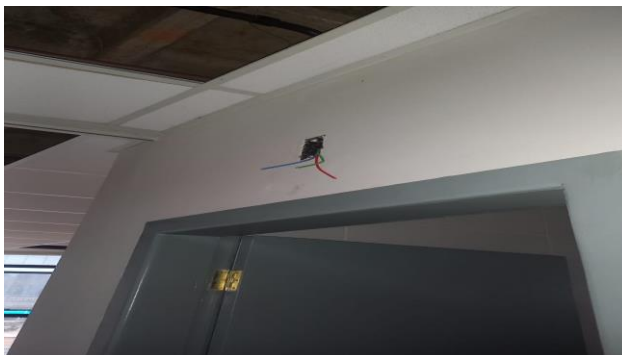
Imagem 76 INSTALAÇÕES ELÉTRICAS DO PRÉDIO ANEXO
