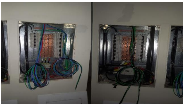
Imagem 75 INSTALAÇÕES ELÉTRICAS DO PRÉDIO ANEXO
