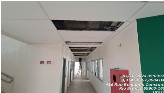
Imagem 78 INSTALAÇÕES ELÉTRICAS DO PRÉDIO ANEXO
