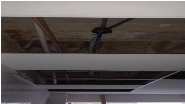
Imagem 73 INSTALAÇÕES ELÉTRICAS DO PRÉDIO ANEXO
