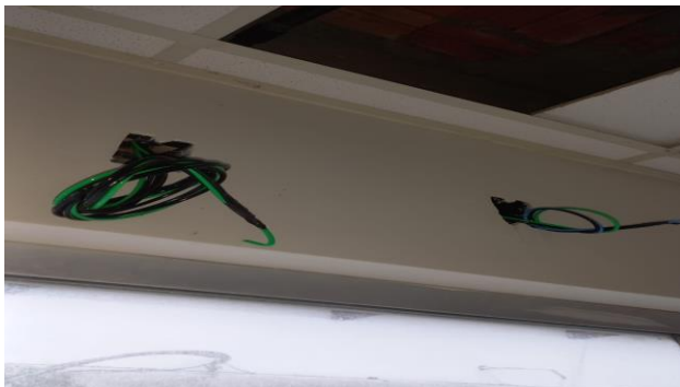
Imagem 74 INSTALAÇÕES ELÉTRICAS DO PRÉDIO ANEXO
