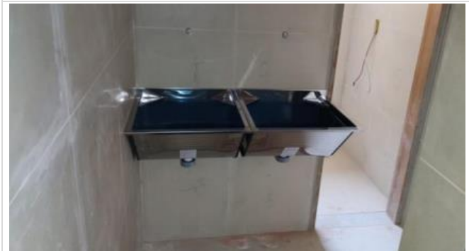
Item: Descrição: INST. TANQUES
