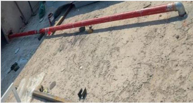
Item: 16.1 Descrição: INST. DE INCENDIO
