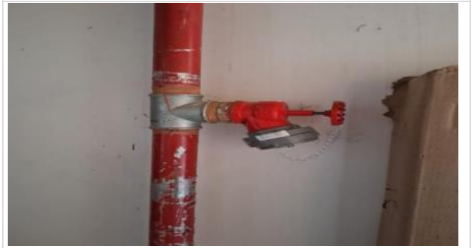
Item: 16.1 Descrição: INST. DE INCENDIO
