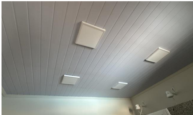
Imagem 50 LUMINÁRIA PLAFON DE SOBREPOR.
