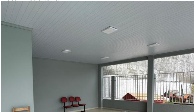
Imagem 51 LUMINÁRIA PLAFON DE SOBREPOR; FORRO PVC.
