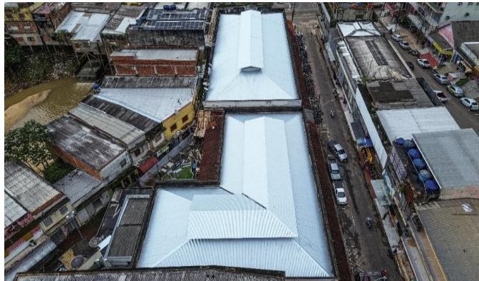
Imagem 10 TELHAMENTO COM TELHA DE AÇO/ALUMÍNIO E = 0,5 MM, COM ATÉ 2 ÁGUAS, INCLUSO IÇAMENTO. AF_07/2019
