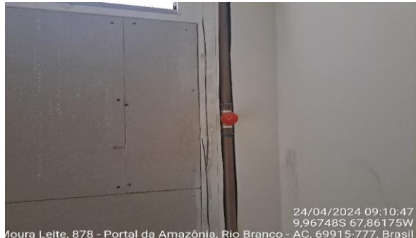
24/04/2024 09:10:47 9,96748S 67,86175W Moura Leite, 878 - Portal da Amazônia, Rio Branco - AC, 69915-777, Brasil Imagem 34 INSTALAÇÕES HIDRÁULICAS
