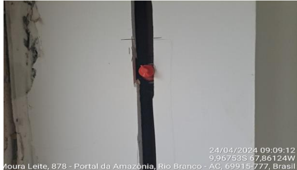
24/04/2024 09:09:12 9,96753S 67,86124W Moura Leite, 878 - Portal da Amazônia, Rio Branco - AC, 69915-777, Brasil Imagem 32 INSTALAÇÕES HIDRÁULICAS
