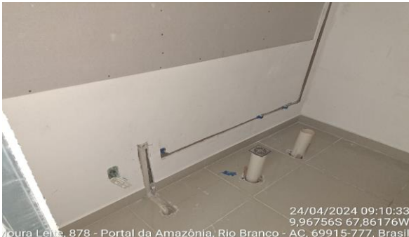
24/04/2024 09:10:33 9,96756S 67,86176W Moura Leite, 878 - Portal da Amazônia, Rio Branco - AC, 69915-777, Brasil Imagem 33 INSTALAÇÕES HIDRÁULICAS E SANITÁRIAS
