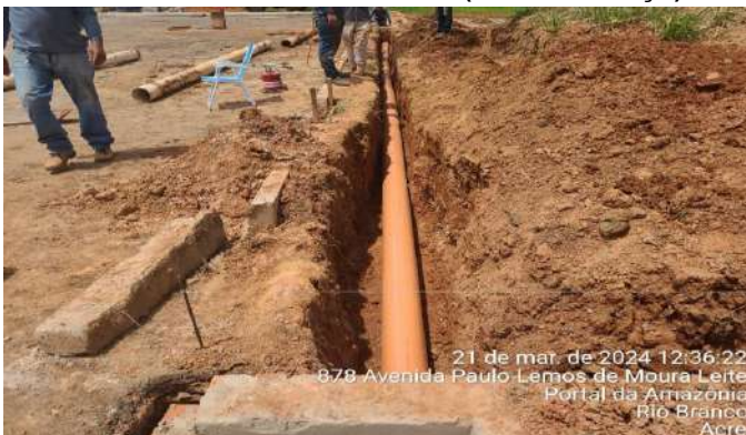
Imagem 15 ESCAVAÇÃO MANUAL, PREPARO DE FUNDO DE VALA, TUBO DE PVC PAREDE MACIÇA JE DN 150MM
