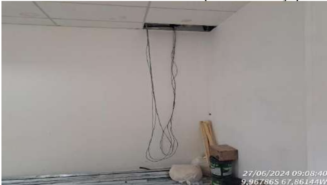
Imagem 261 PASSAGEM DE CABO CAT 6
