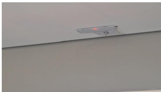
Imagem 86 LUMINÁRIA DE EMERGÊNCIA
