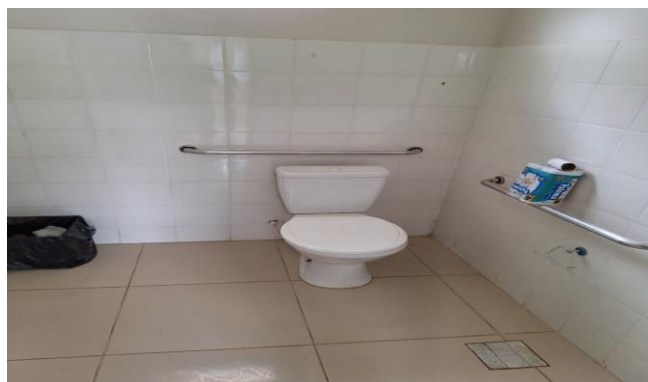
Imagem 9 BARRA DE APOIO DO BANHEIRO PCD
