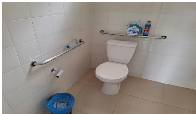
Imagem 8 BARRA DE APOIO DO BANHEIRO PCD
