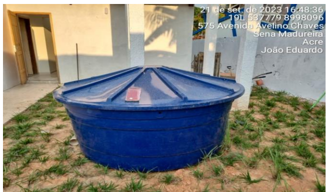
Imagem 9 CAIXA DE ÁGUA
