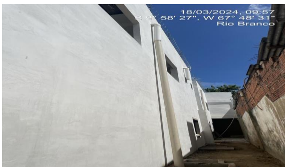
Imagem 39 Vista dos ramais de descida para a drenagem pluvial
