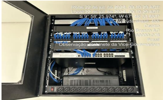
Imagem 163 Instalação do rack de rede lógica do subsolo
