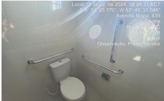
Imagem 103 Barras de acessibilidade no WC acessível
