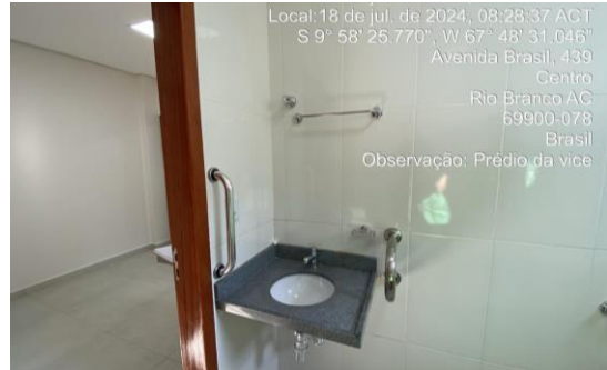
Imagem 104 Barras de acessibilidade no WC acessível
