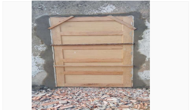
Imagem 8 Porta para acesso a obra
