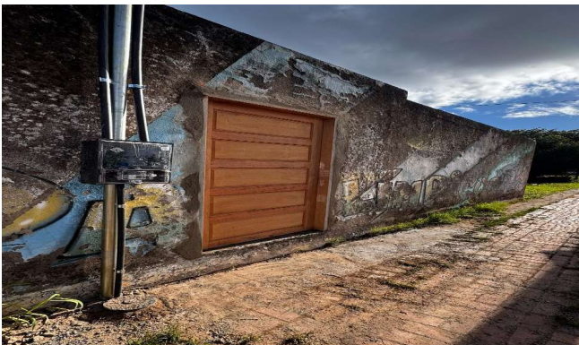
Imagem 5 Ligação provisória de energia
