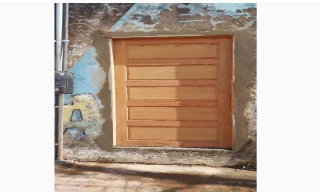
Imagem 9 Porta para acesso a obra
